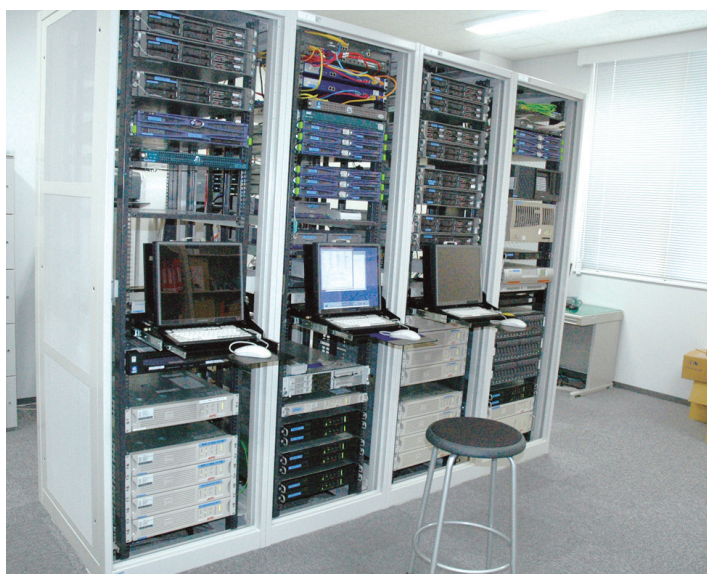
ネットワーク管理室
