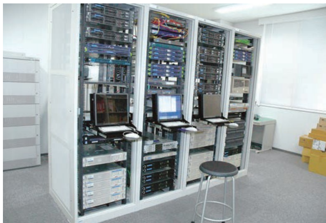
ネットワーク管理室
