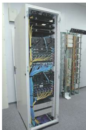
ネットワーク管理室 Network Control Room
