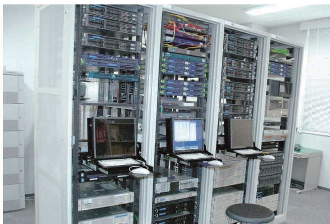
ネットワーク管理室のサーバの一部
